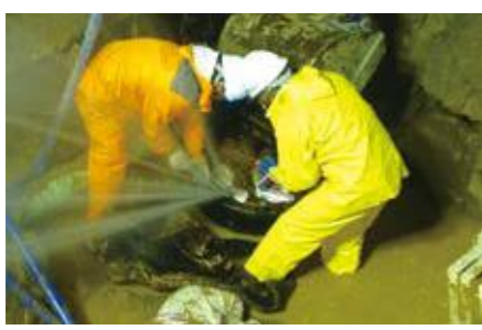
応急修繕や漏水調査などの現場力の継承が課題
